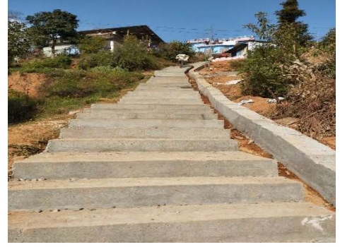
खाडामुख देखि बाहुन टोल हंडै ठाडो बाटो सिंङी निर्माण बनेपा नपा-५ काभ्रे
